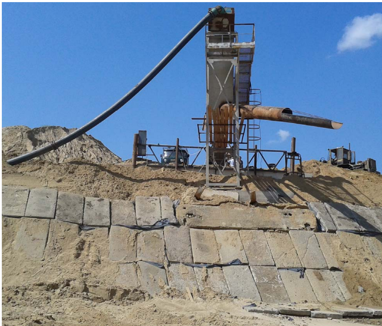
Рис. 2. Мойка песка гравитационная МПГ-1600 на промплощадке карьера Восточно-Бугского-2 месторождения песка
